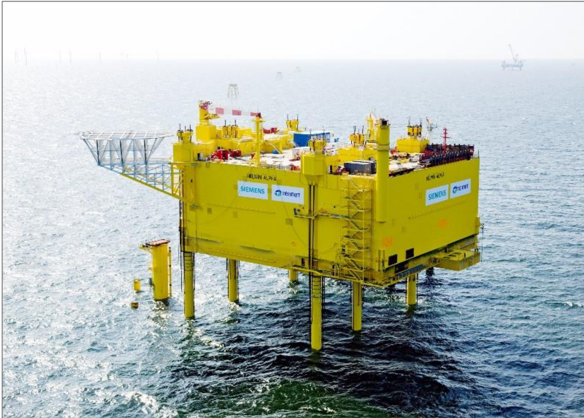
Figur2-8. HVDC HelWin Alpha, ett exempel på en självinstallerande station som bogseras på plats och lyfts upp med hjälp av lyftben. Källa: www.overdick-offshore.com .
