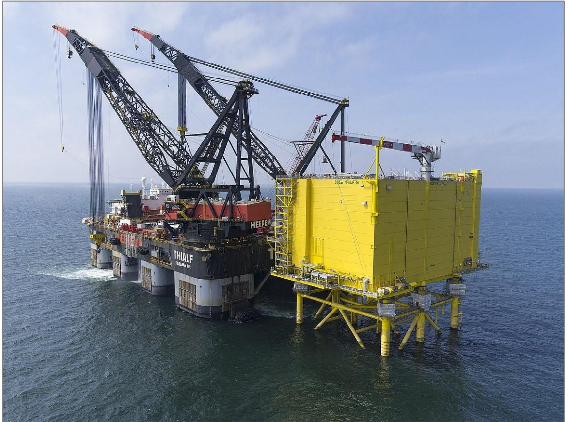
Figur2-7. HVDC DolWin Alpha, ett exempel på en station med fackverksfundament. Kranfartygets lyftkapacitet är cirka 22 000 ton. Källa: www.overdick-offshore.com .
