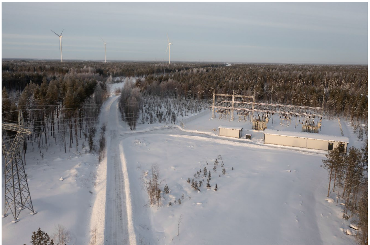
Kuva 1-4. Esimerkki tuulivoimahankkeen sähköasemasta (valokuva: Petteri Löppönen / OX2)
