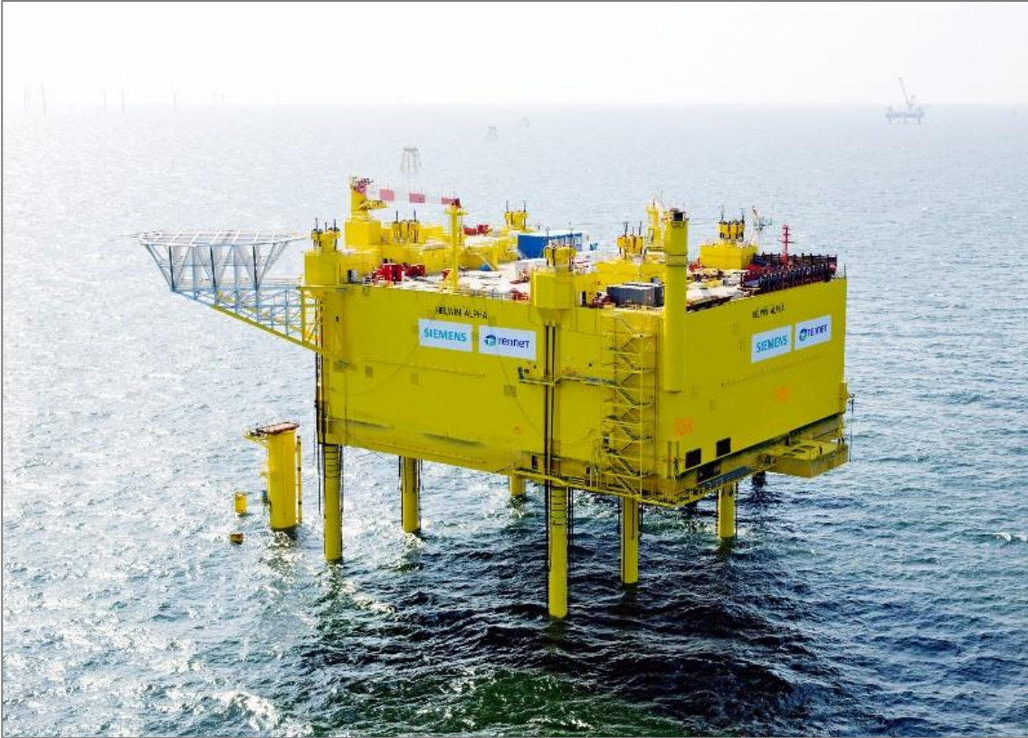
Kuva 4-8. HVDC HelWin Alpha, esimerkki itseasentuvasta asemasta, joka hinataan paikalleen ja nostetaan ylös nostojalkojen avulla. Lähde: www.overdick-offshore.com .
