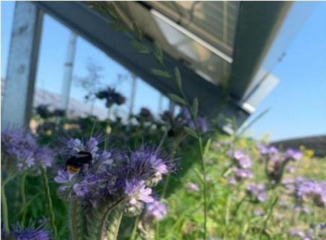
Figur 5.1. Blommande flora under solpaneler. Foto: Magnus Fast, OX2.
