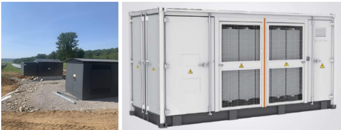
Figur 4.5. Vänster: exempel på utformning av transformatorstation inom anläggningen (foto: Magnus Fast OX2). Höger: exempel på utformning av uppsamlingsstation inom anläggningen (foto: OX2).
