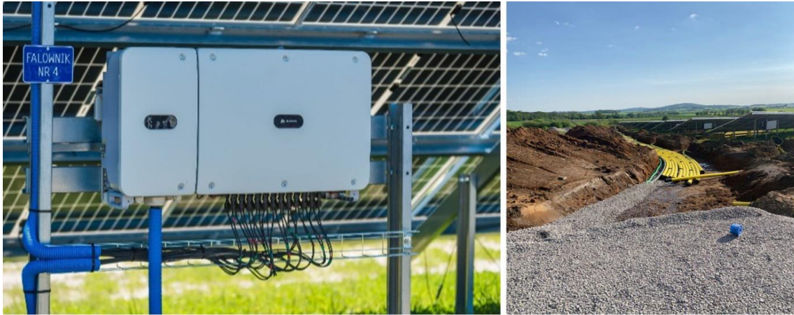
Figur 4.4. Vänster: växelriktare som monterats på markställning (bildkälla: www.ske-solar.com). Höger: exempel på kabelschakt inom anläggningen (foto: Magnus Fast, OX2).
