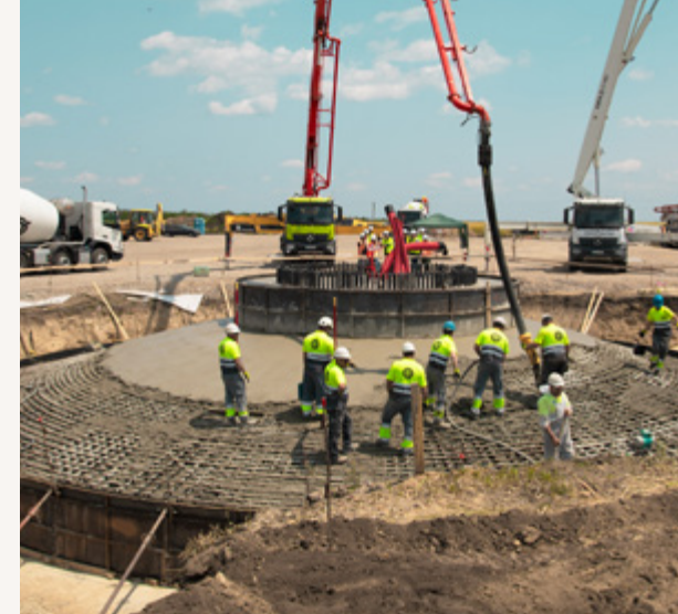
Vindparken Green Breeze är OX2:s första projekt som byggs i Rumänien.
