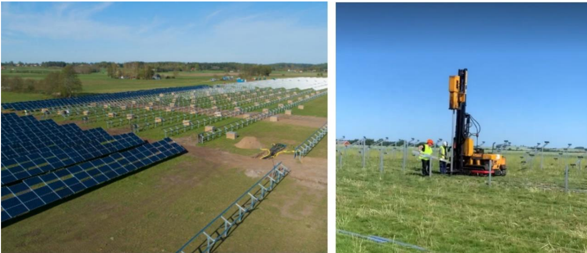
Figur 4.10. Vänster: exempel på montage av fasta solpaneler på markställningar. Anläggningen är Svea Solars solpark i Sjöbo (Bildkälla: Ny Teknik). Höger: Pålning av balkar med pålningsmaskin (Foto: Magnus Fast, OX2).
