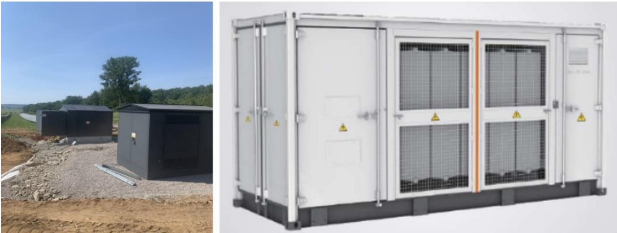
Figur 4.13. Vänster: exempel på utformning av transformatorstation inom anläggningen (foto: Magnus Fast OX2). Höger: exempel på utformning av uppsamlingsstation inom anläggningen (Foto: OX2).
