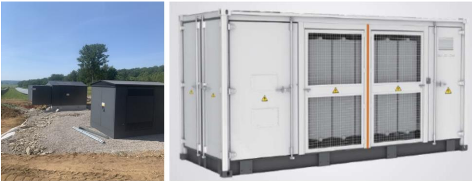
Figur 5-3. Vänster: exempel på utformning av transformatorstation inom anläggningen (foto: Magnus Fast OX2). Höger: exempel på utformning av mottagningsstation inom anläggningen (foto: OX2).
