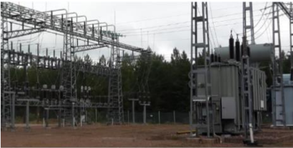
Figur 5-4. Exempel station/ställverk för anslutning av solenergianläggningen mot befintligt elnät.
