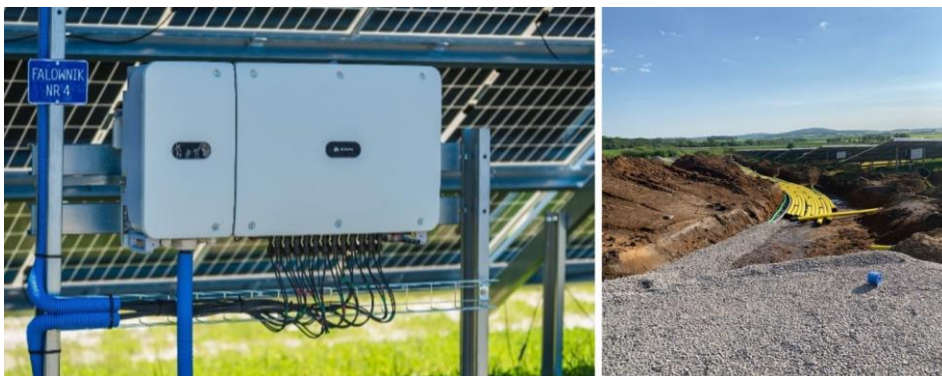
Figur 9. Vänster: växelriktare som monterats på markställning (bildkälla: www.ske-solar.com). Höger: exempel på kabelschakt inom anläggningen (foto: Magnus Fast, OX2).
