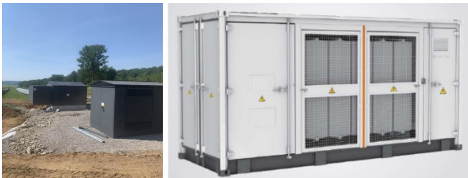
Figur 10. Vänster: exempel på utformning av transformatorstation inom anläggningen (foto: Magnus Fast OX2). Höger: exempel på utformning av mottagningsstation inom anläggningen (foto: OX2).
