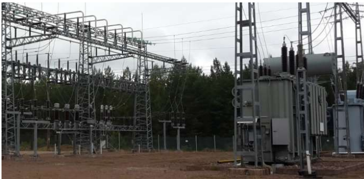
Figur 12. Exempel på ställverk för anslutning av solcellsparken till elnätet. Bildkälla: www.vattenfall.com
