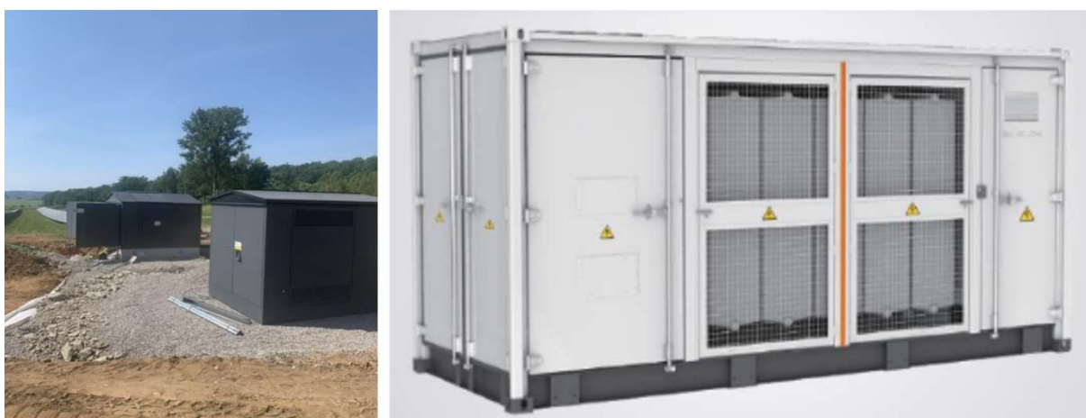
Figur 16. Vänster: exempel på utformning av transformatorstation inom anläggningen (foto: Magnus Fast OX2). Höger: exempel på utformning av mottagningsstation inom anläggningen (foto: OX2).
