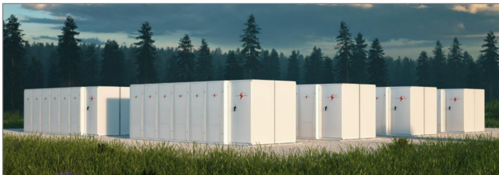
Figur 12. Bild som visar exempel på utformning av en batterianläggning med modulär lösning.
