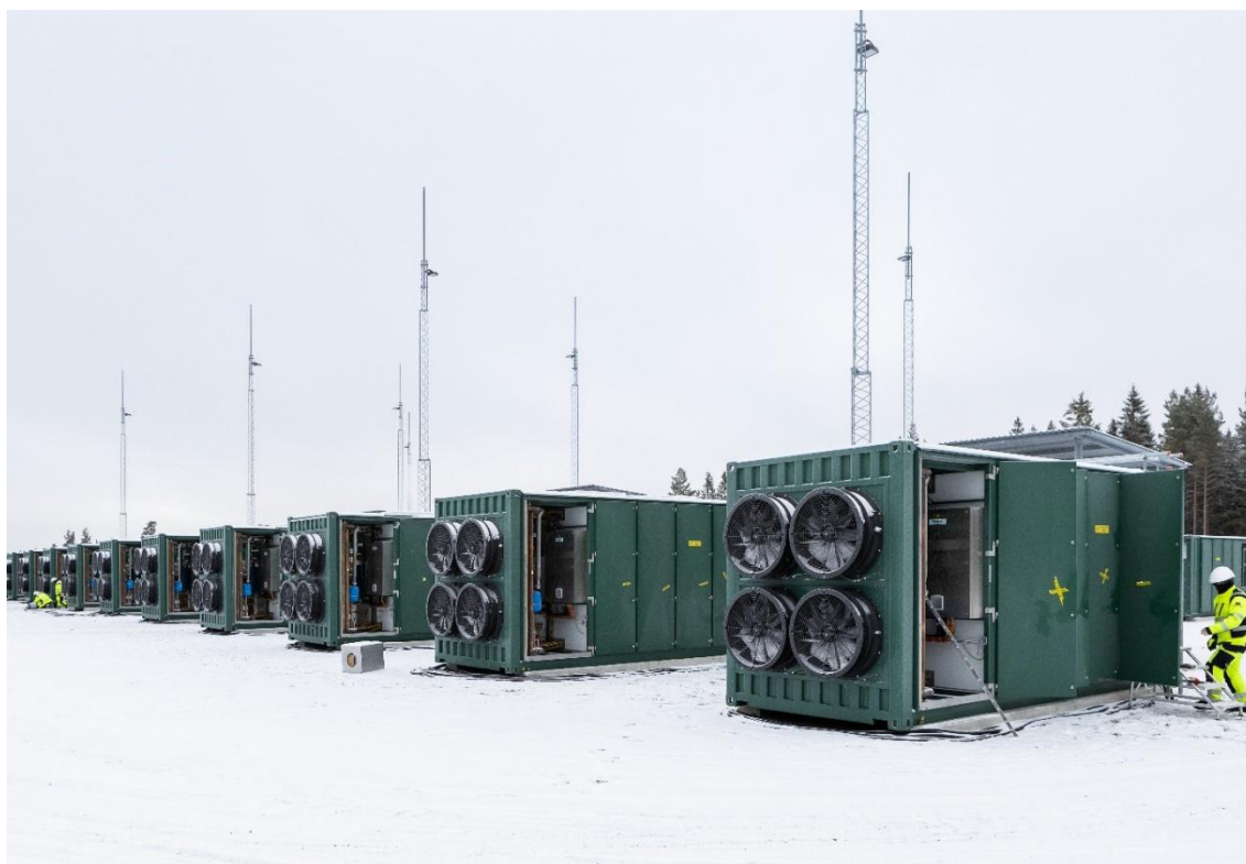
Figur 5. Bild som visar exempel på utformning av en batterianläggning. Foto: OX2
