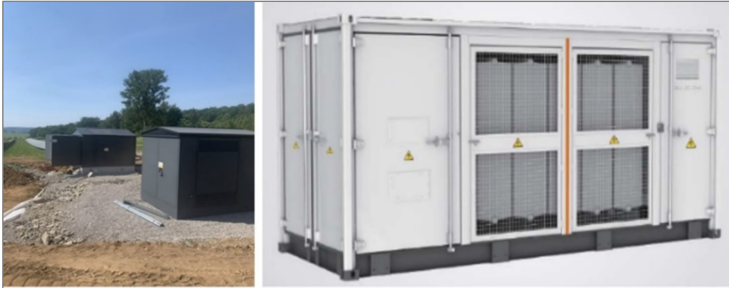
Figur 8. Exempel på transformatorkiosk (till vänster) och uppsamlingsstation (till höger) inom en solpark. Bild: OX2 AB.
