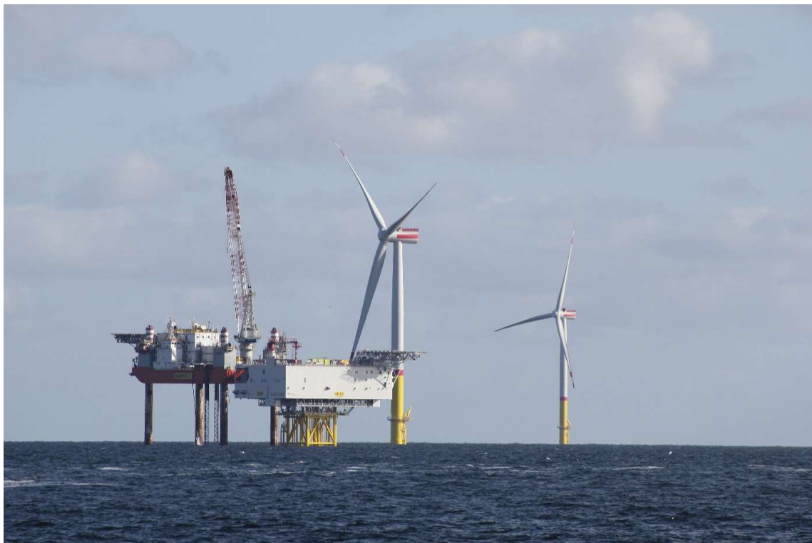
Figur 19. Stödbensfartyg vid transformatorstation.
